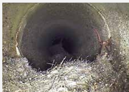
Massiver Wurzeleinwuchs als Hindernis.
