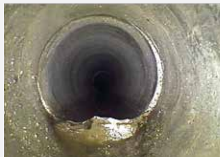
Verschobene Rohrverbindung und harte Ablagerungen.
