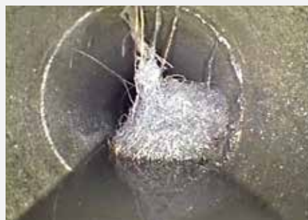
Komplexes Wurzelwerk an einer Rohrverbindung.
