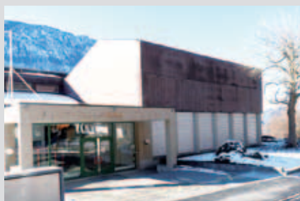
Sanierungsbedürftig: Aula Kapellen
